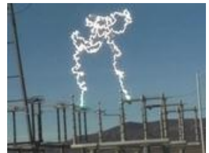
Arc électrique entre deux pylônes d'une centrale électrique
